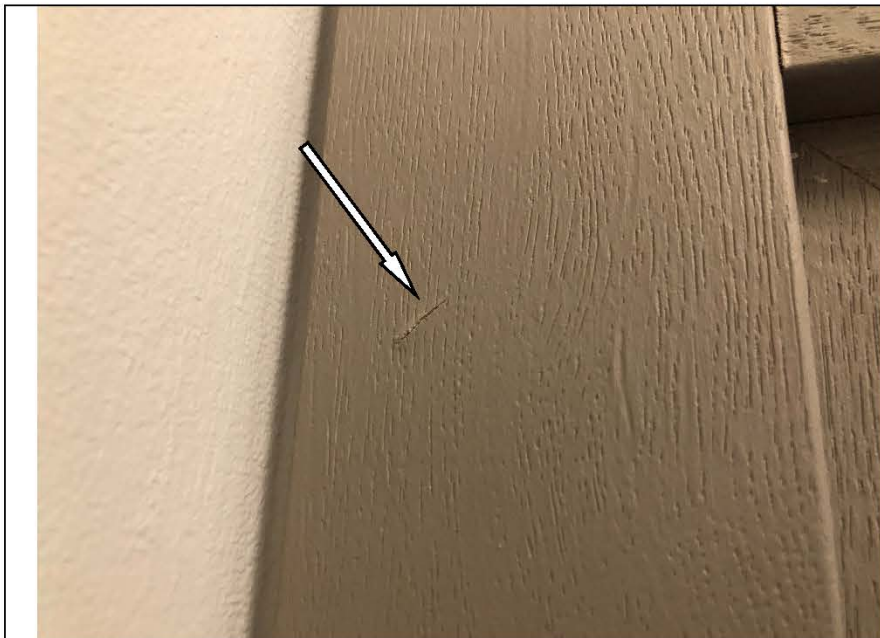
Фото №13. Царапина на наличнике деревянного дверного блока в кухне в квартире.
