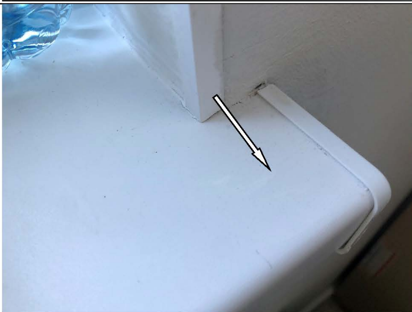
Фото №32. Загрязнения на подоконной доске в кухне в квартире.
