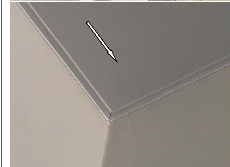
Фото №24. Загрязнения на полотне натяжного потолка в спальне в квартире.
