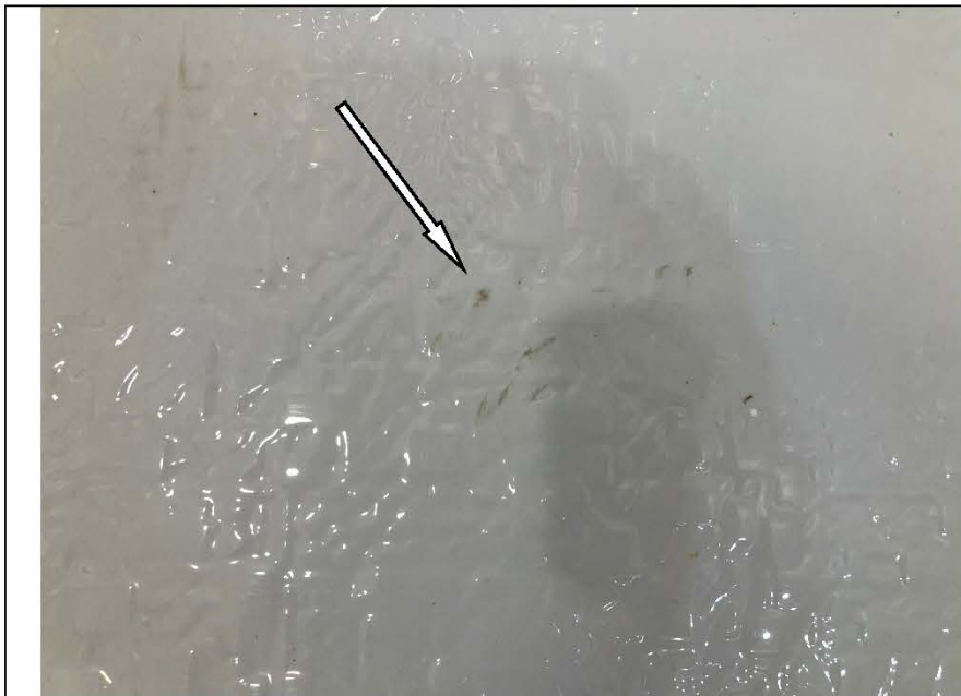
Фото №46. Царапина, загрязнения на ванной в ванной комнате в квартире.
