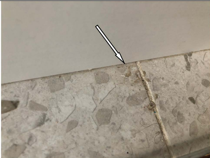
Фото №37. Загрязнения на напольной керамической плитке в кухне в квартире.
