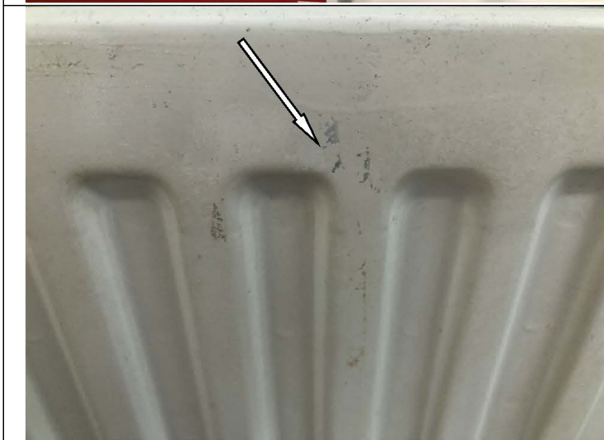
Фото №48. Загрязнения на кожухе отопительного прибора в кухне в квартире.
