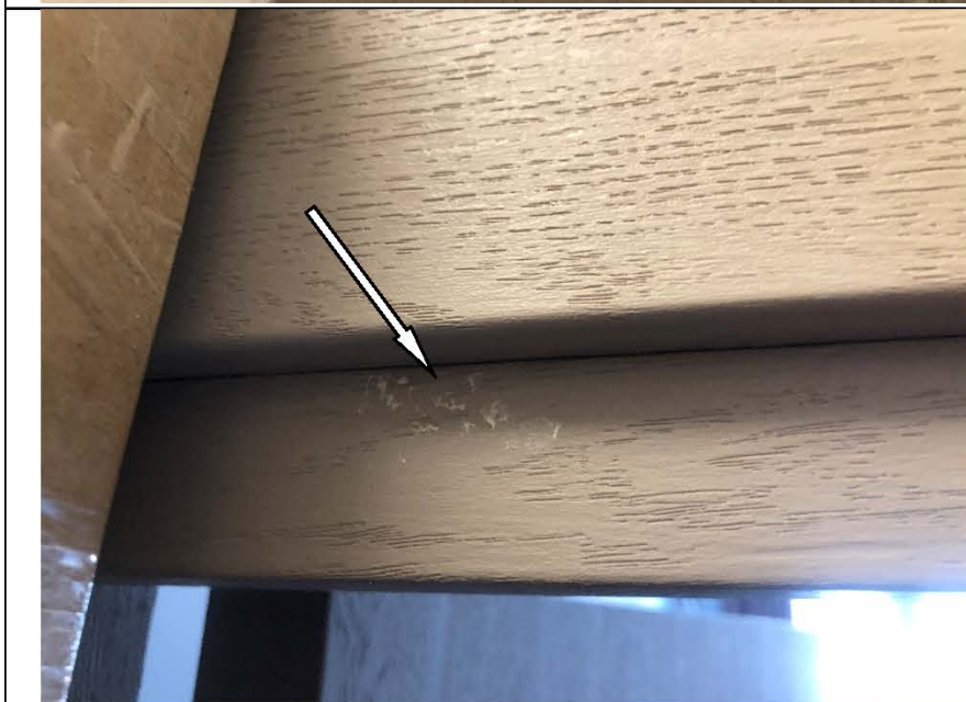
Фото №14. Загрязнения на коробке деревянного дверного блока в спальне в квартире.
