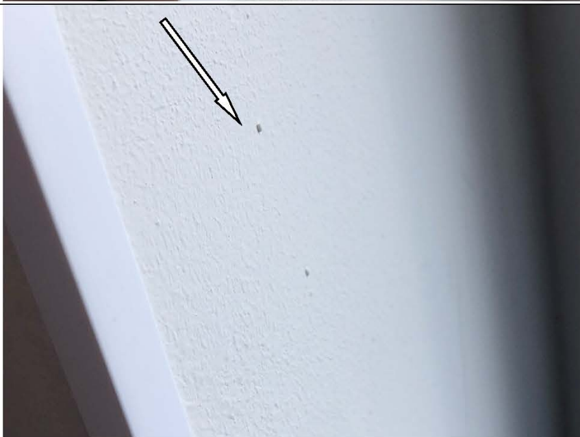
Фото №30. Неровности, сколы на окрашенных откосах оконного блока ПВХ в кухне в квартире.
