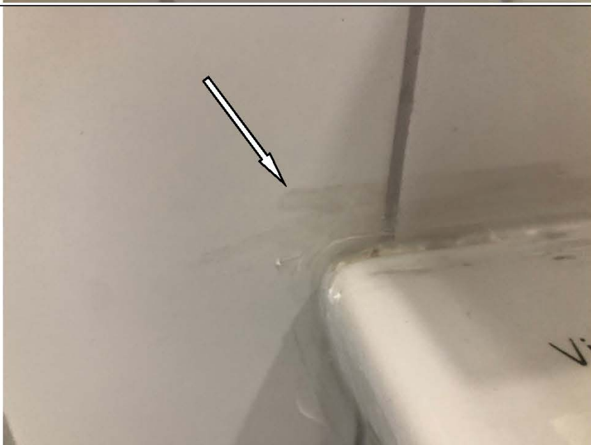
Фото №45. Загрязнения на настенной керамической плитке в ванной комнате в квартире.
