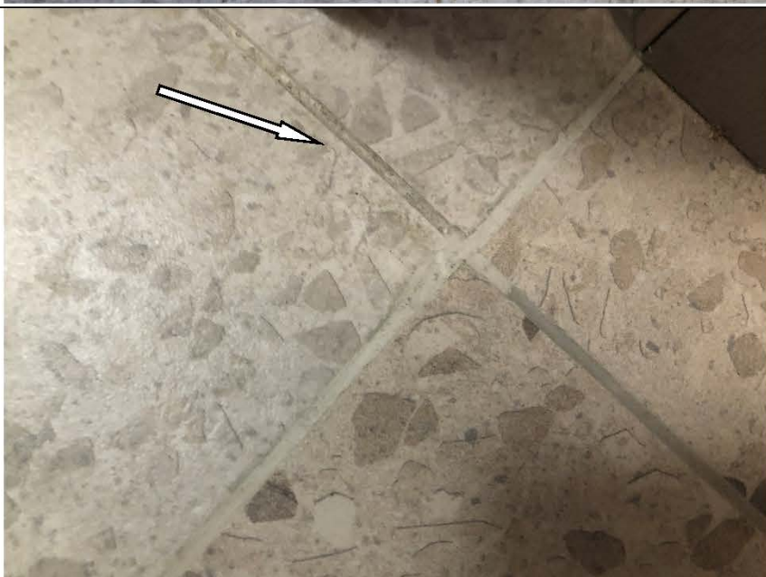
Фото №39. Неровный шов напольной керамической плитки в кладовке в квартире.
