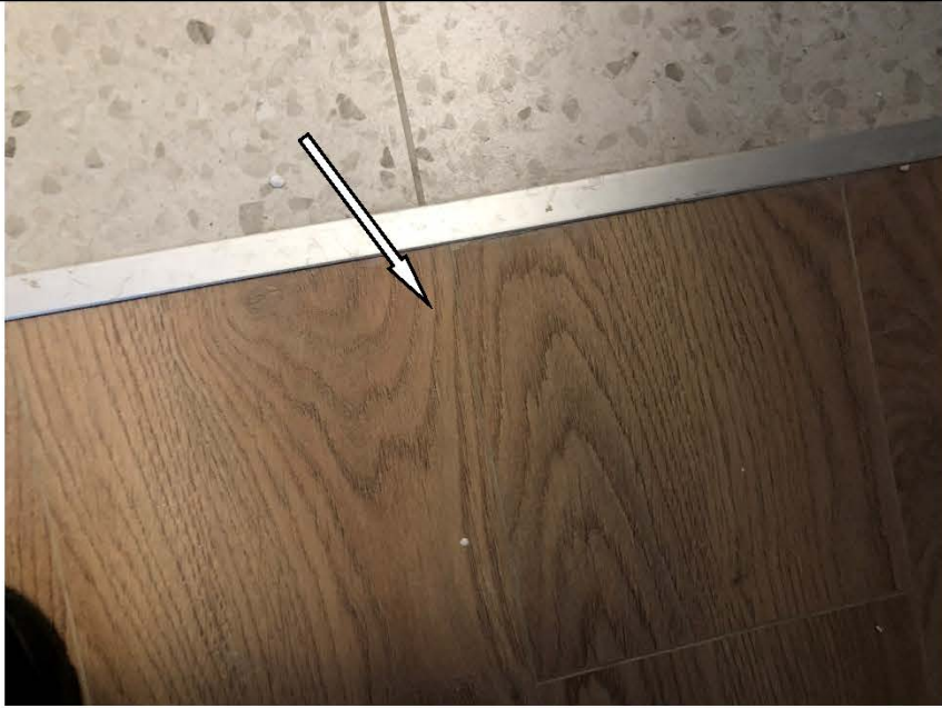
Фото №19. Прогиб на ламинате в спальне в квартире.
