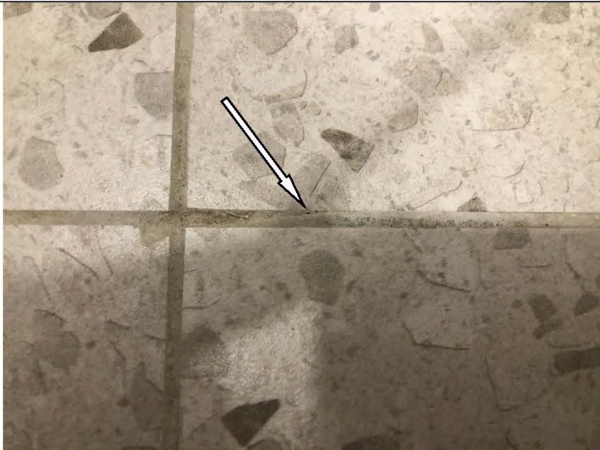
Фото №40. Неровный шов напольной керамической плитки в ванной комнате в квартире.
