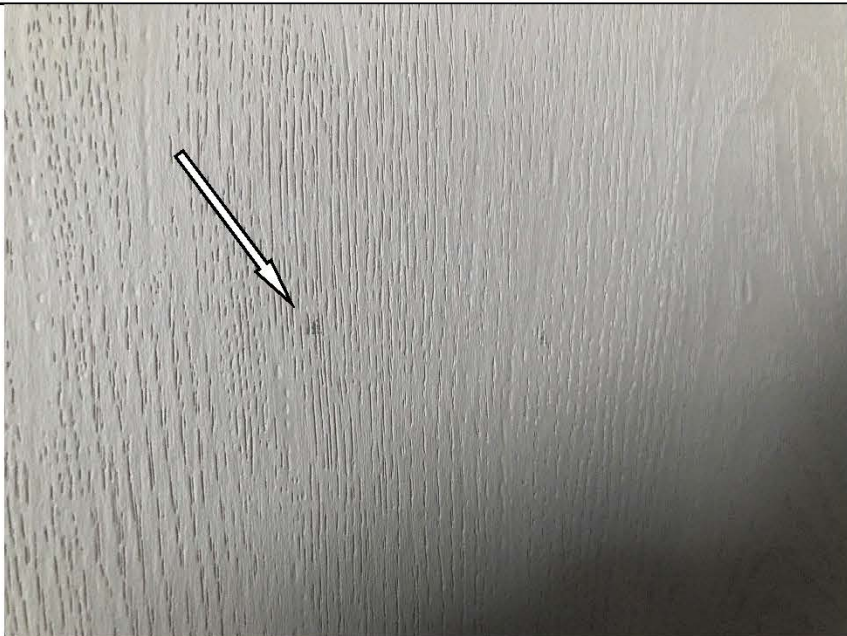
Фото №20. Загрязнения на полотне деревянного дверного блока в спальне в квартире.
