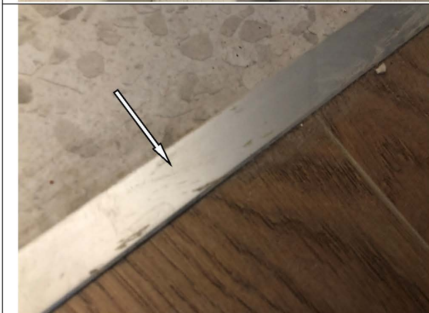
Фото №18. Царапины на напольном металлическом порожке в спальне в квартире.
