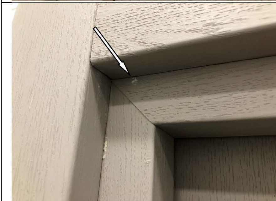
Фото №17. Загрязнения на коробке деревянного дверного блока в ванной комнате в квартире.
