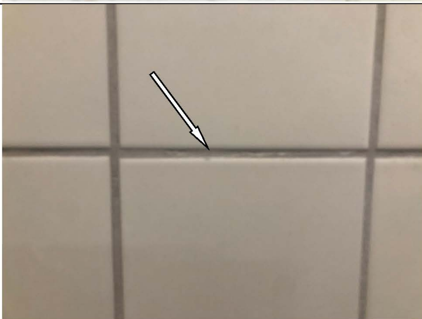
Фото №44. Неровный шов напольной керамической плитки в ванной комнате в квартире.
