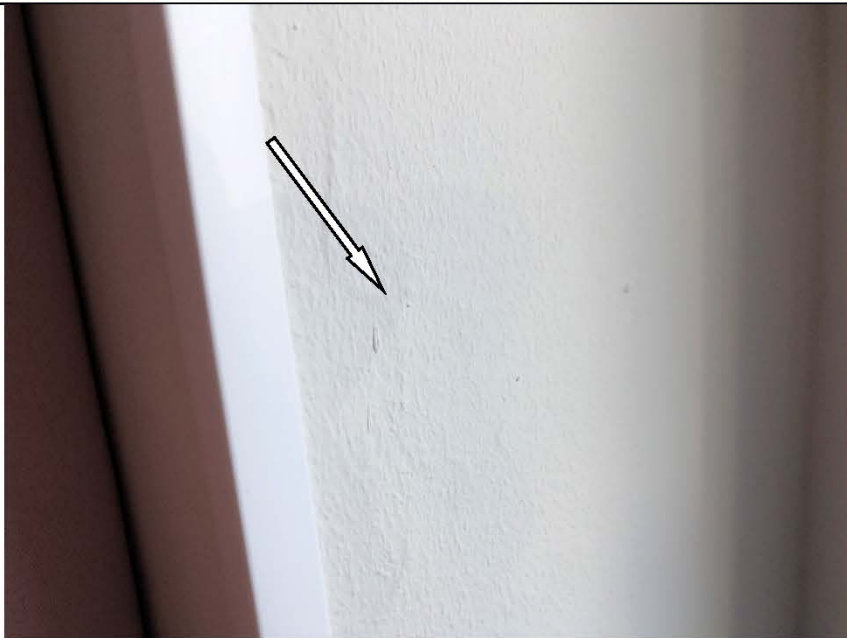
Фото №29. Неровности, сколы на окрашенных откосах оконного блока ПВХ в спальне в квартире.
