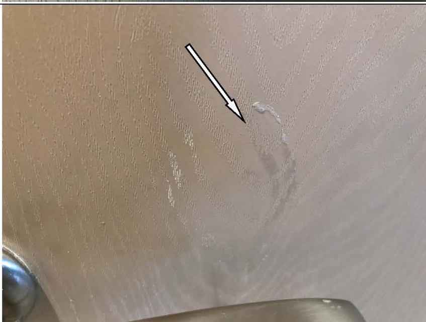
Фото №21. Загрязнения на полотне комбинированного дверного блока в коридоре в квартире.
