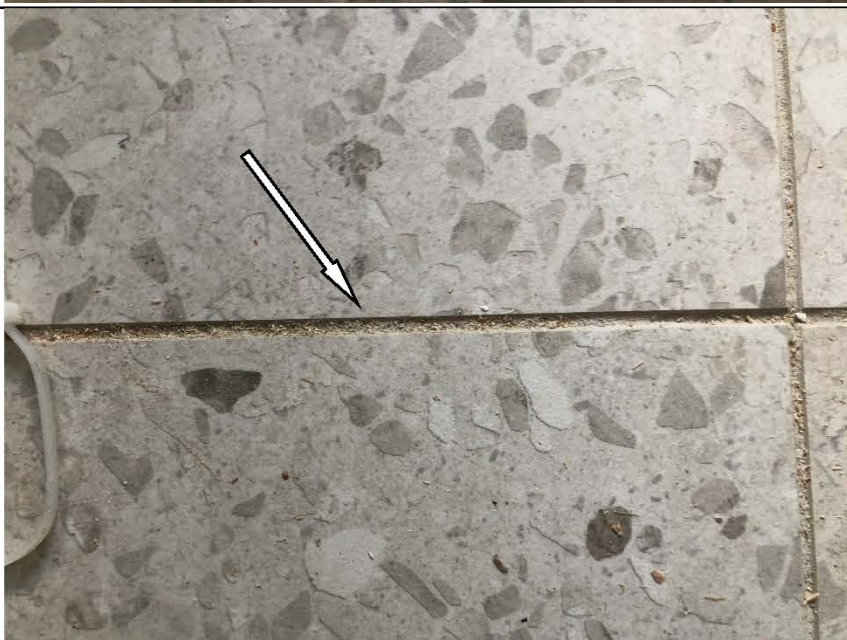
Фото №41. Неровный шов напольной керамической плитки в кухне в квартире.
