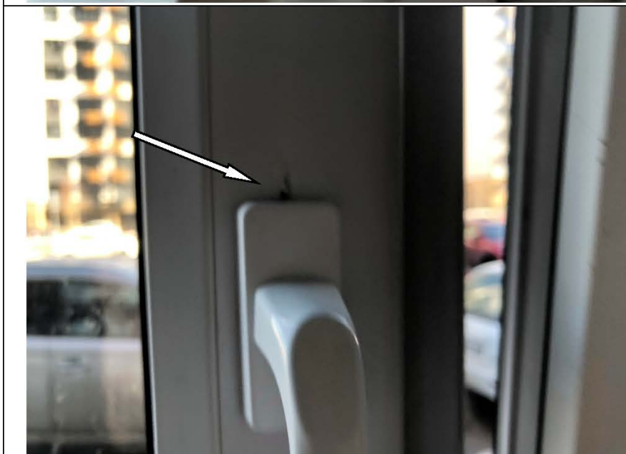
Фото №36. Загрязнения на профиле оконного блока ПВХ в кухне в квартире.
