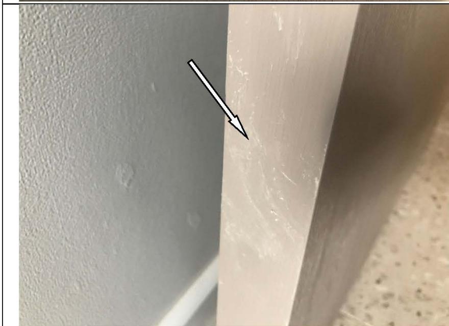
Фото №23. Загрязнения на полотне деревянного дверного блока в кухне в квартире.
