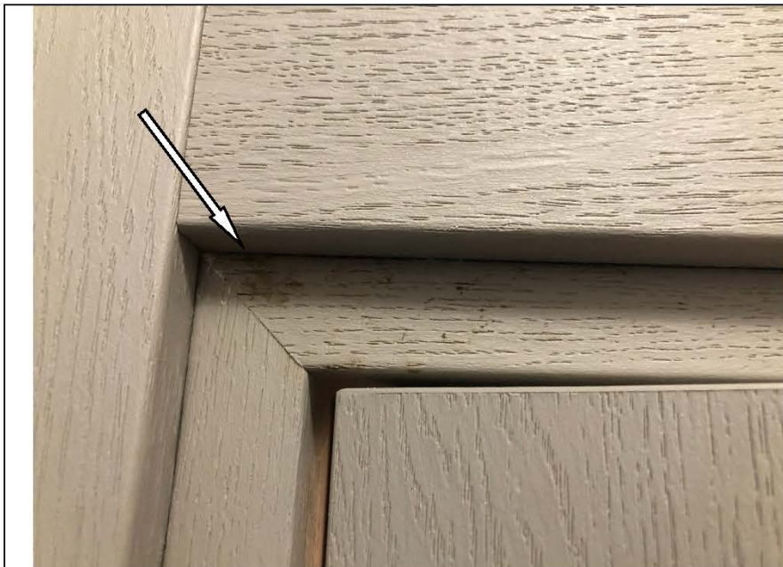
Фото №16. Загрязнения на коробке деревянного дверного блока в кладовке в квартире.
