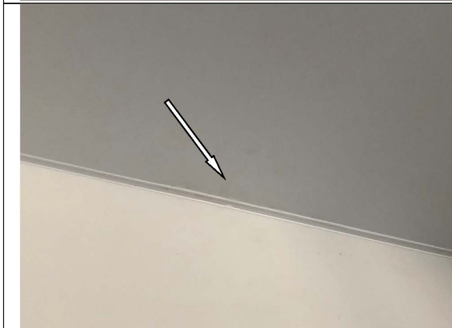
Фото №27. Загрязнения на полотне натяжного потолка в кухне в квартире.
