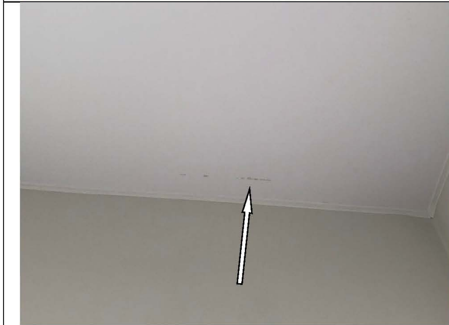
Фото №26. Загрязнения на полотне натяжного потолка в кладовке в квартире.
